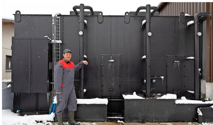
Der Biowäscher reinigt die Stallluft in einem dreistufigen Verfahren von Staub, Ammoniak und Gerüchen.
