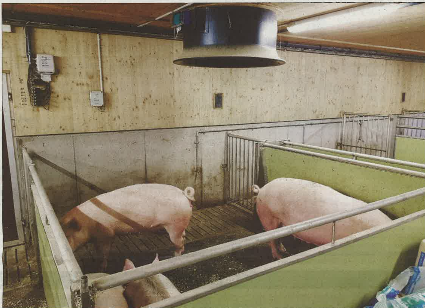
Der Luftstrom wird unter den Tieren hindurch in den Stall geleitet und danach durch den Kamin abgezogen. Durch die Körperwärme der Tiere wird das Stallklima ausgeglichen.
