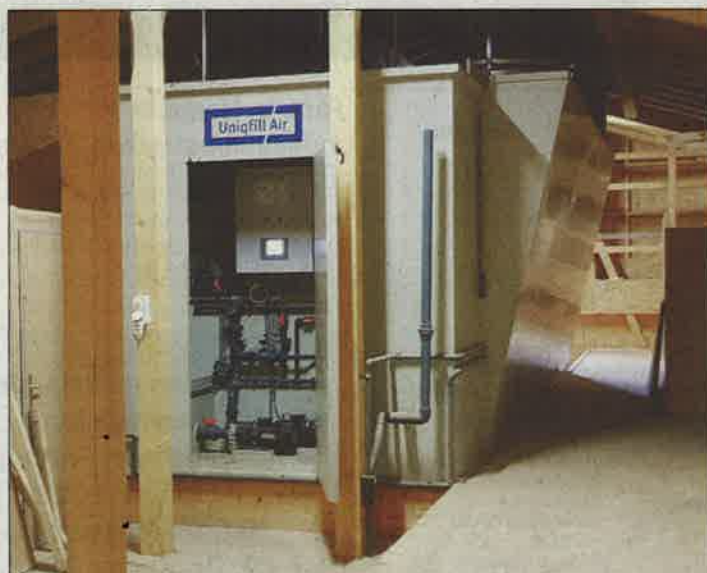
Die Luftwaschanlage im Obergeschoss ist auf die Sommerluftfrate
