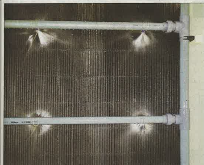
Mit Wasser wird der Staub aus der Abluft gebunden; mithilfe von
